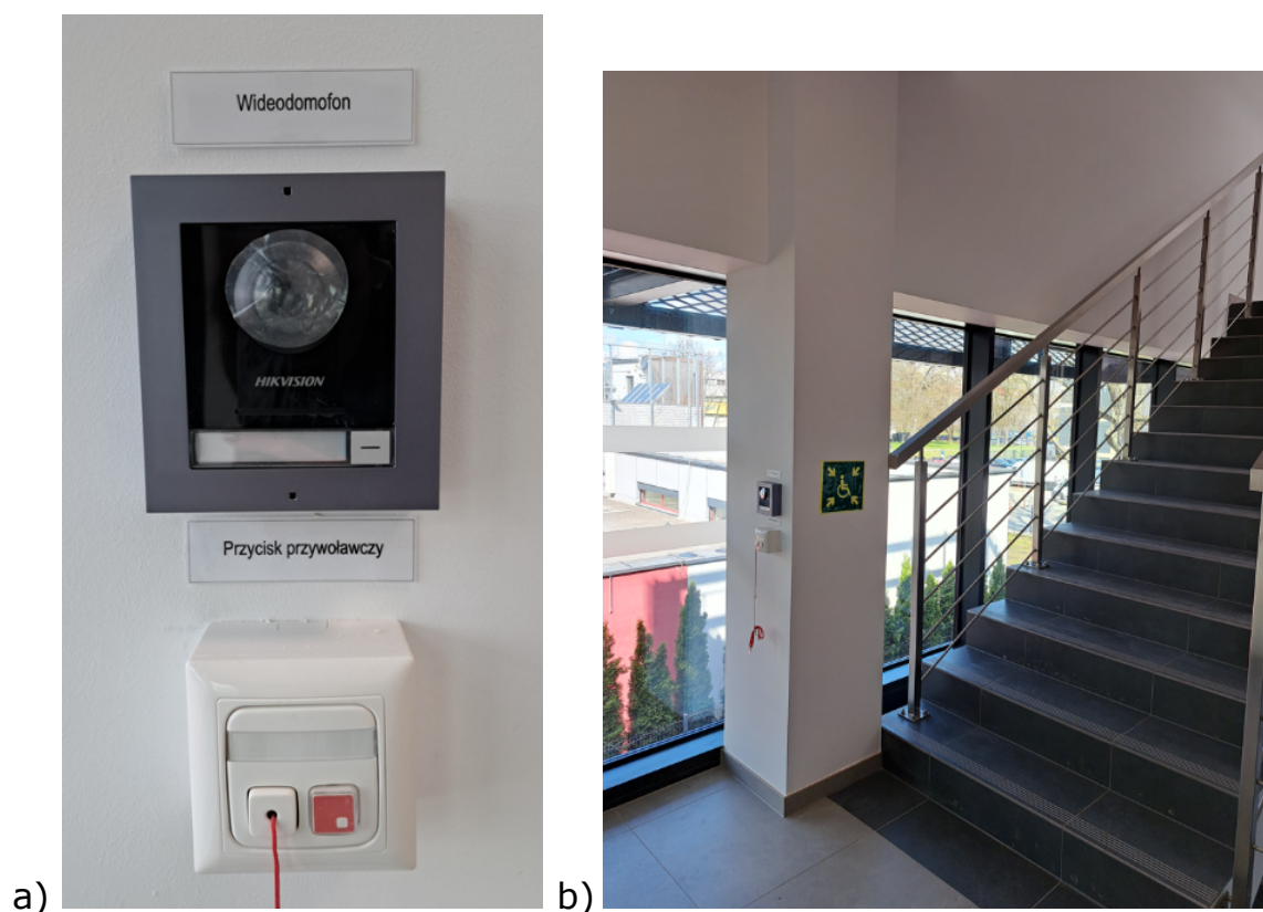
Rysunek 52. a) Zdjęcie wyposażenia miejsca oczekiwania na uratowanie w budynku SCK, b) Zdjęcie miejsca oczekiwania na uratowanie w budynku SCK
