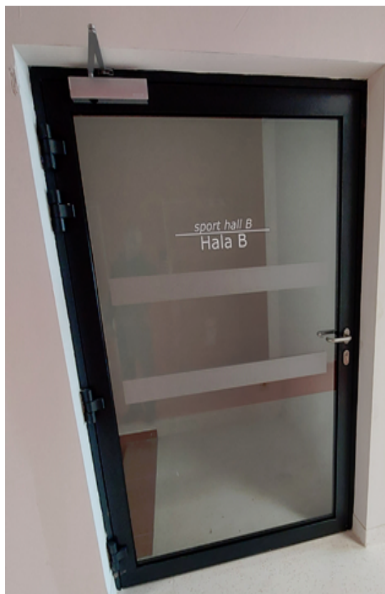
Rysunek 17. Zdjęcie oznaczenia przeszkleń w budynku Hali Sportowej AGH
